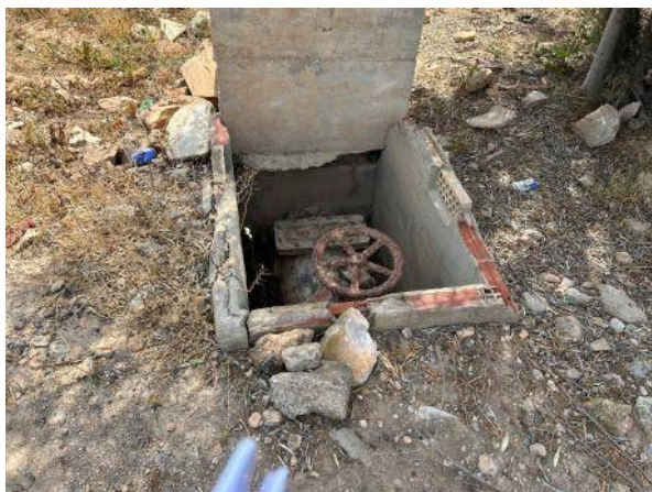
Imagen 17.5: Arqueta de riego con válvula junto a carretera. Coordenadas: X = 711997.3350 Y = 4387558.3686
