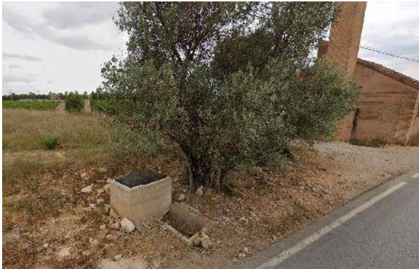
Imagen 14.3: Arqueta de riego con válvula junto a carretera. Coordenadas: X = 711997.3350 Y = 4387558.3686
